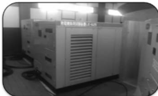
【某発電所、地下吹き抜け空間】
